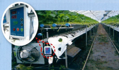
산란광 효과로 흐린 날도 온실 내부가 밝았다. 고실 아래 10m 간격으로 냉각과 방열 목적으로 라디에이터를 설치하고 각각에 온도 제어기로 자동 조절되고 있다.
